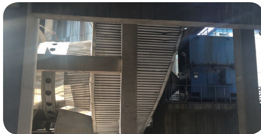
现场设备照片
